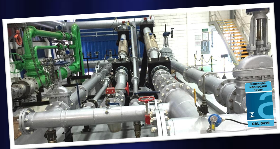
Laboratório acreditado de calibração de medidores de vazão - Macaé - RJ
