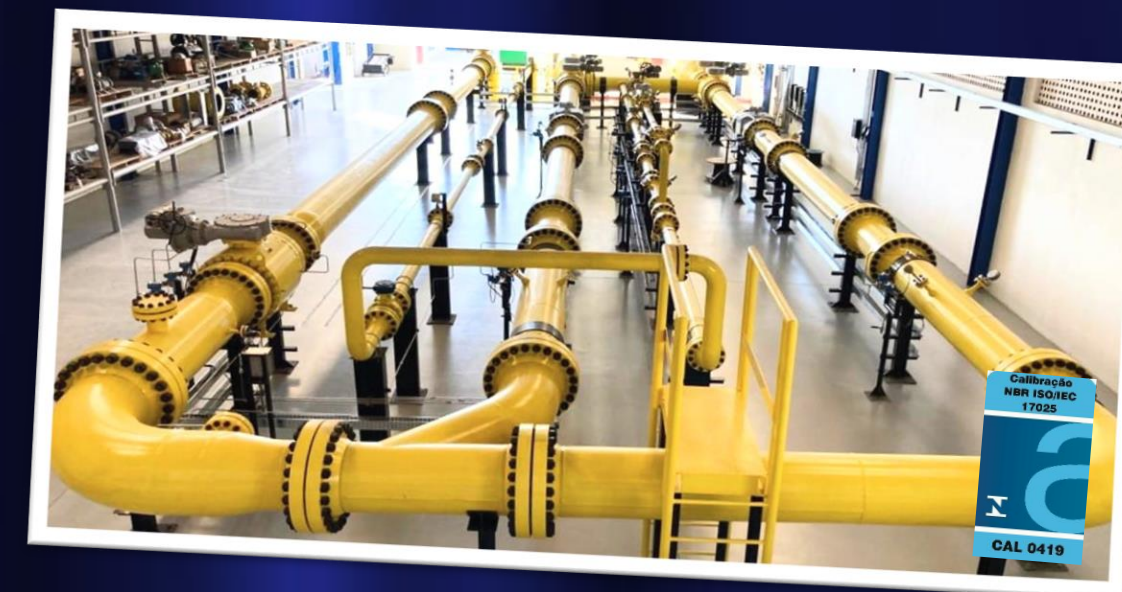
Laboratório de calibração de gás – Macaé - RJ
