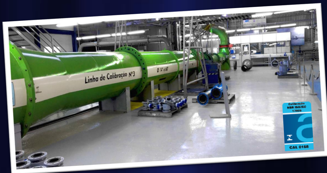
Laboratório acreditado de calibração de medidores de vazão - Embu das Artes - SP
